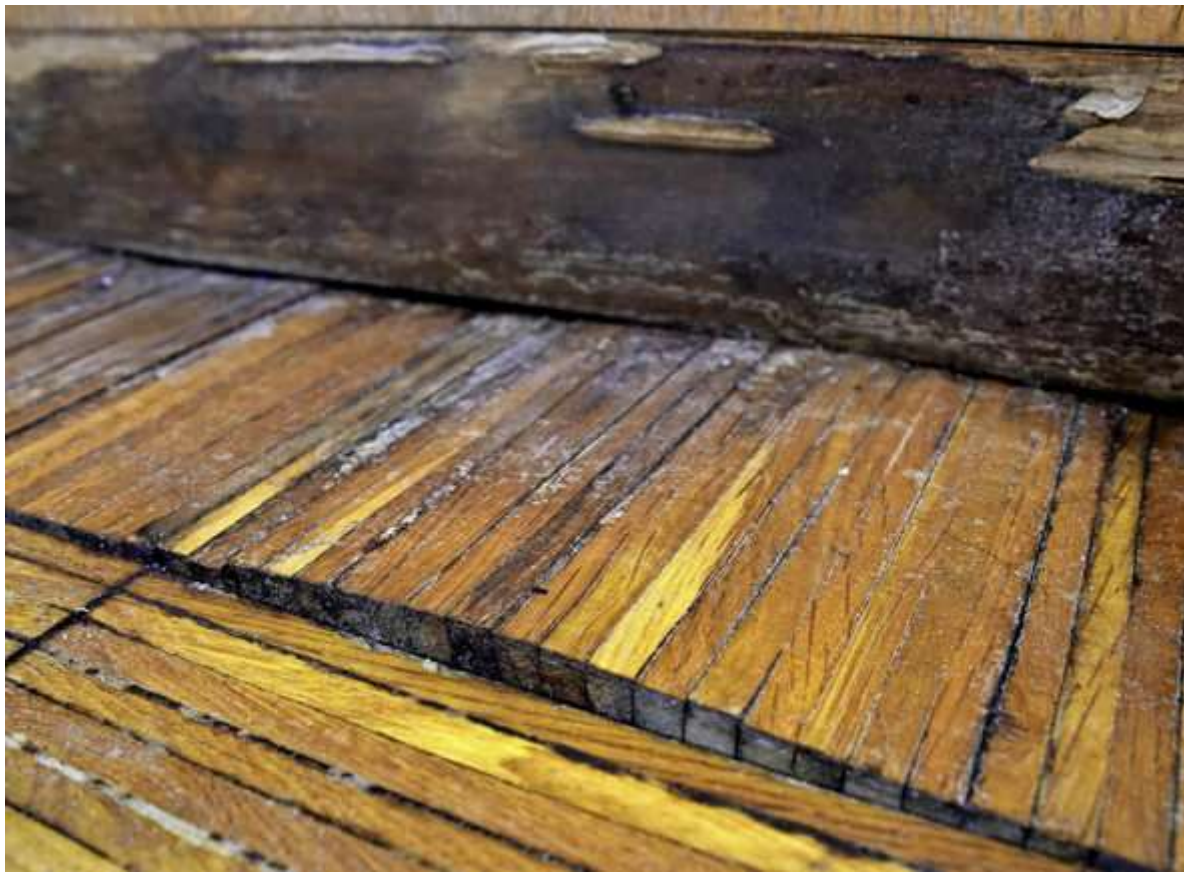
Durch den Dachschaden ist der Boden dauernd feucht, da lupft's das Parket. Foto: Thomas Kunz
